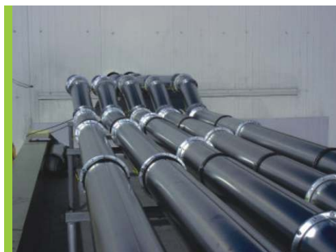
Transport pneumatyczny ścinków z linii technologicznych do separatora
