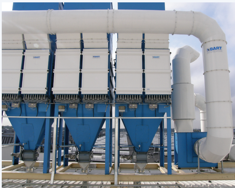
FOT. 4 Filtracja pyłów chemicznych
