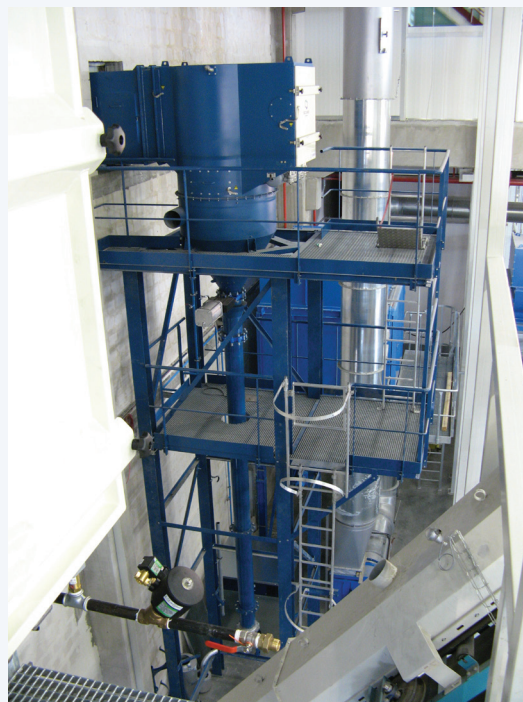
FOT. 2 Instalacja centralnego odkurzania
