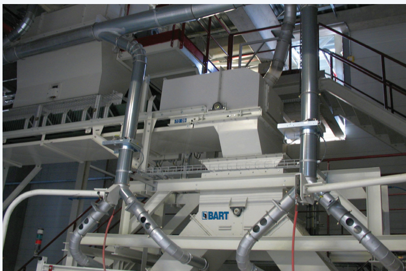
FOT. 1 Filtracja pyłów chemicznych
